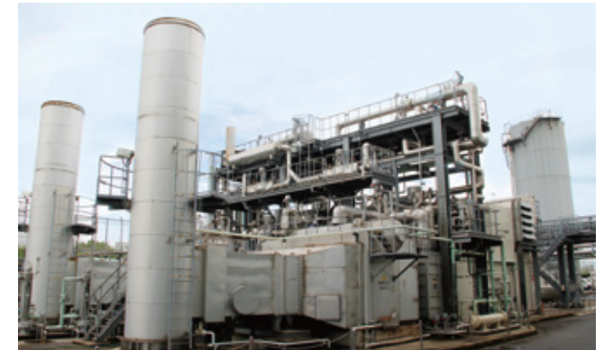
コージェネレーションシステム
