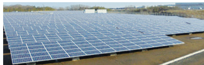
三里塚太陽光発電所
