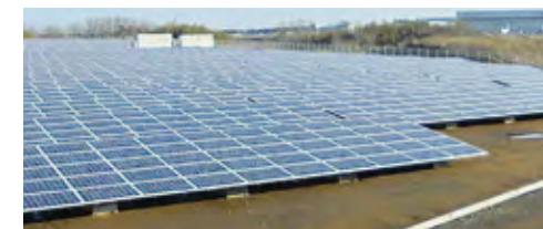
三里塚太陽光発電所
