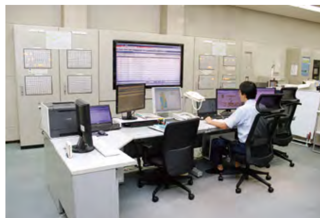
第2旅客ターミナルビル内の中央監視室
