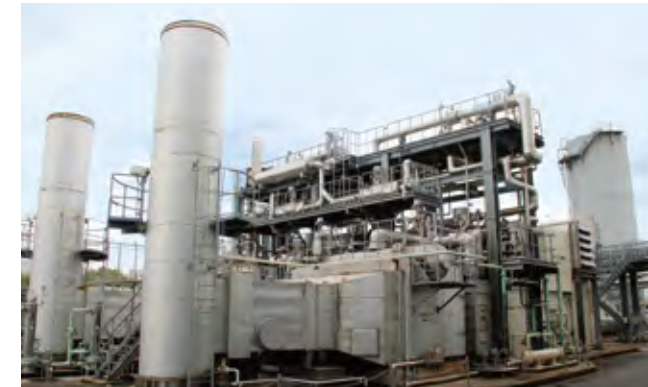
コージェネレーションシステム
